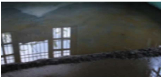
Εικόνα 1.22 Ανάβλυση νερού λόγω εκτόνωσης υδροστατικής πίεσης (Goda, 2015)
