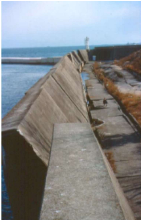
Εικόνα 1.8 Αστοχία λιμενικού κρητιδότοιχου (Μπουκουβάλας, 2019)
