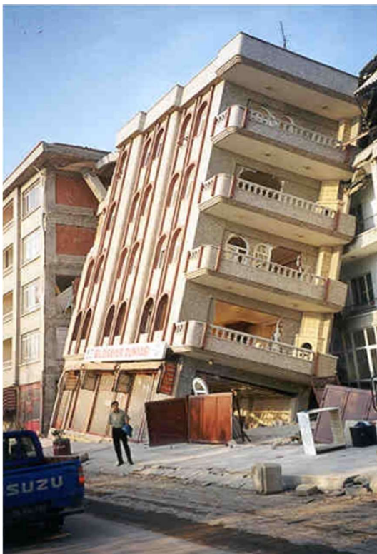
Εικόνα 1.9 κ' 1.10 Υποχώρηση πολυκατοικιών λόγω ρευστοποίησης του εδάφους (D'Ayala, 2003)
