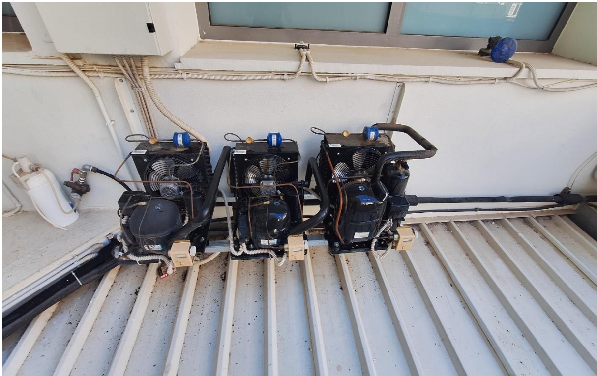
Εικόνα 2.28: Εξωτερικές μονάδες καταψύξεων
