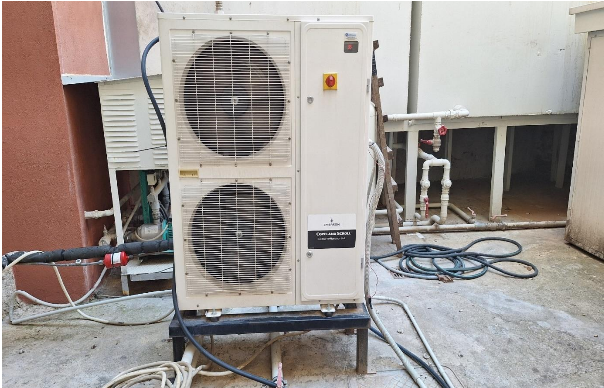
Εικόνα 2.27: Εξωτερική μονάδα ψυγείων και θαλάμων συντήρησης
