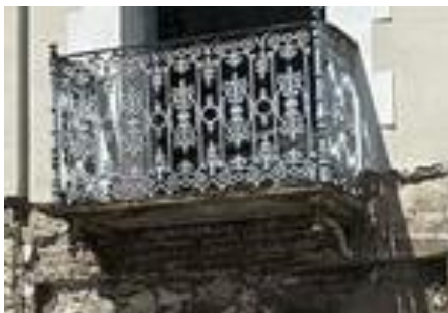
Εικόνα 28: Υφιστάμενη κατάσταση μπαλκονιών. (Πηγή: Αρχείο νεοτέρων μνημείων)
