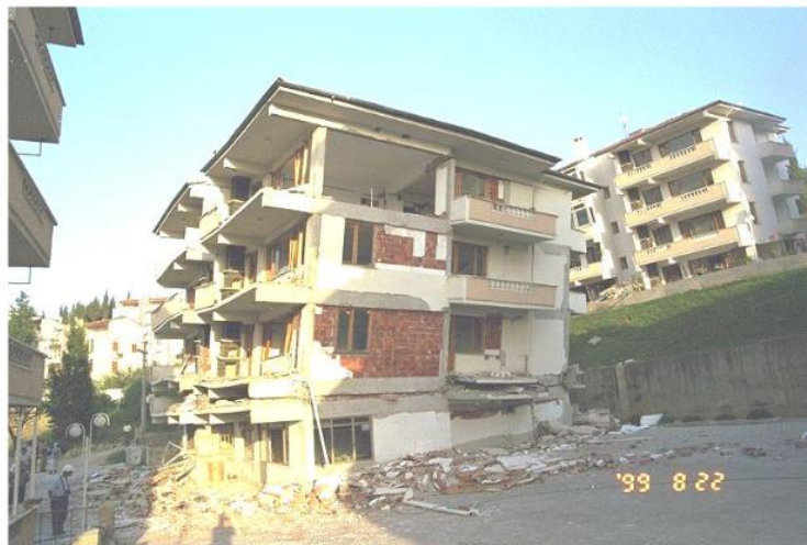
Εικόνα 4.3: Κατάρρευση κτιρίου έπειτα από το σεισμό του 1999 λόγω ανάπτυξης μαλακού ορόφου.
