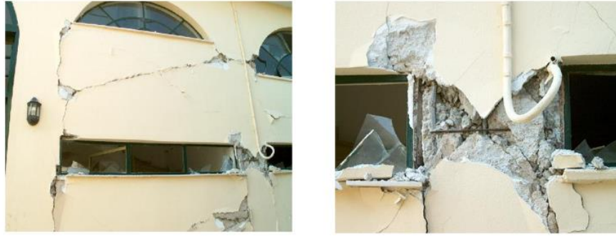
Εικόνα 4.10: Διατμητική αστοχία λόγω ύπαρξης κοντών υποστυλωμάτων (22).
