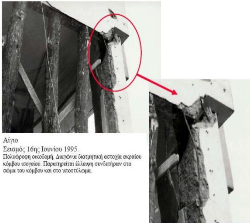
Εικόνα 4.18: Διατμητική αστοχία διαγώνιου κόμβου στο σεισμό του Αιγίου, 1995 (22).
