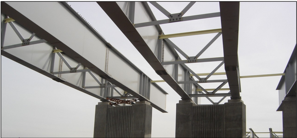
Εικόνα 4.2.3 Εγκάρσιοι σύνδεσμοι γεφυρών, Από Bracing systems , του M.Sansom, 10 Ιουνίου 2012, SteelConstruction. Ανακτήθηκε 20 Ιουλίου 2024 από https://www.steelconstruction.info/Bracing_systems Copyright 2012 του M.Sansom
