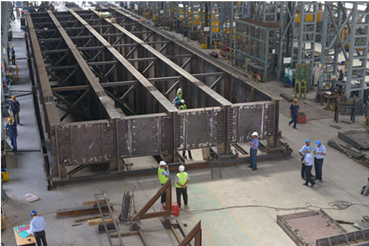
Εικόνα 4.1.2 Διαδικασία κατασκευής πλακοδοκών, Από Plate Girders , της Indiana Group, Ιούλιος 2017, IndianaGroup. Ανακτήθηκε 20 Ιουλίου 2024 από http://www.indianagroup.com/plate-girders/ Copyright 2017 της Indiana Group
