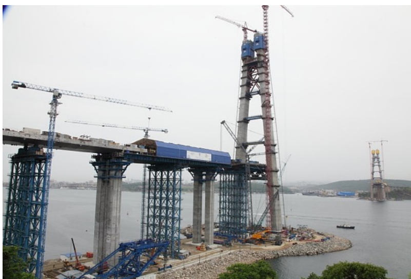
Εικόνα 5.2.27 Κατασκευή πυλώνων γέφυρας Russky, Από Russky Island Bridge , της RusMost.ru, 1 Ιουλίου 2011, Structurae. Ανακτήθηκε 30 Ιουλίου 2024 από https://structurae.net/en/media/212199-russky-island-bridge Copyright 2011 της RusMost.ru
