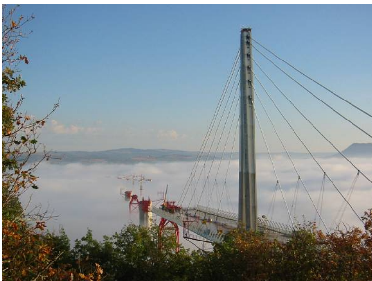
Εικόνα 5.2.21 Κατασκευή καταστρώματος γέφυρας, Από Millau Viaduct , των CEVM Eiffage / Foster and Partners, Οκτώβριος 2003, Structurae. Ανακτήθηκε 30 Ιουλίου 2024 από https://structurae.net/en/media/14296-millau-viaduct-under-constructionsource-unknown Copyright 2003 των CEVM Eiffage / Foster and Partners
