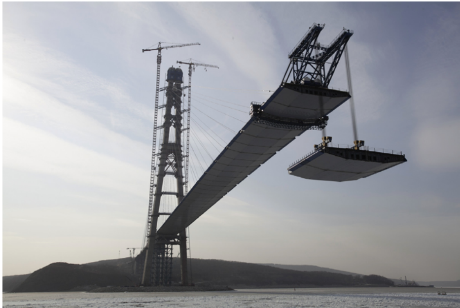
Εικόνα 5.2.29 Τοποθέτηση ορθοτροπικών πλακών της γέφυρας Russky, Από « Case study: the Russky bridge», του A.Pipinato, 2016, Στο Innovative bridge design handbook . σελ. 678. Copyright 2011 της SK MOST Group
