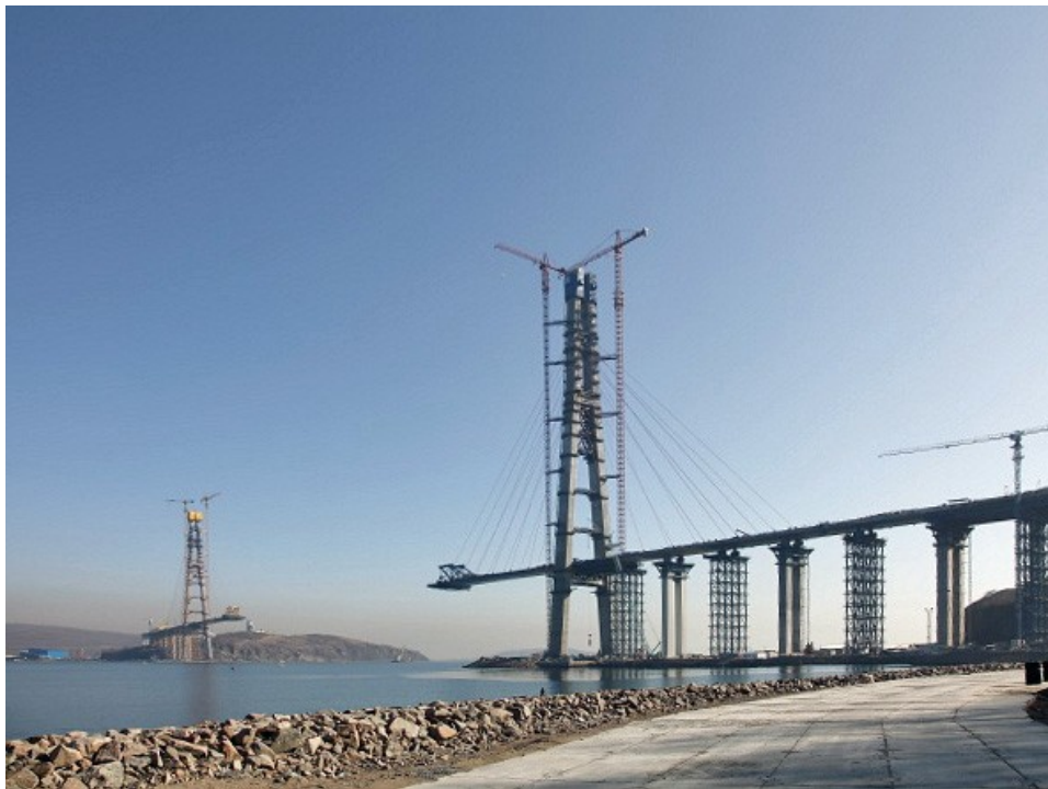
Εικόνα 5.2.28 Τοποθέτηση καλωδίων και προβολοδόμηση της γέφυρας Russky, Από Russky Island Bridge , της m03g, 10 Νοεμβρίου 2011, Structurae. Ανακτήθηκε 30 Ιουλίου 2024 από https://structurae.net/en/media/212200-russky-island-bridge Copyright 2011 της m03g
