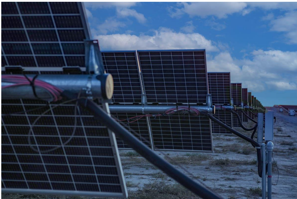
Εικόνα 3.2 Άποψη από την καλωδίωση ΦΒ πάνελ
