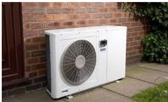
Εικόνα 1: Εξωτερικός εναλλάκτης θερμότητας - αντλίας θερμότητας πηγής αέρα
