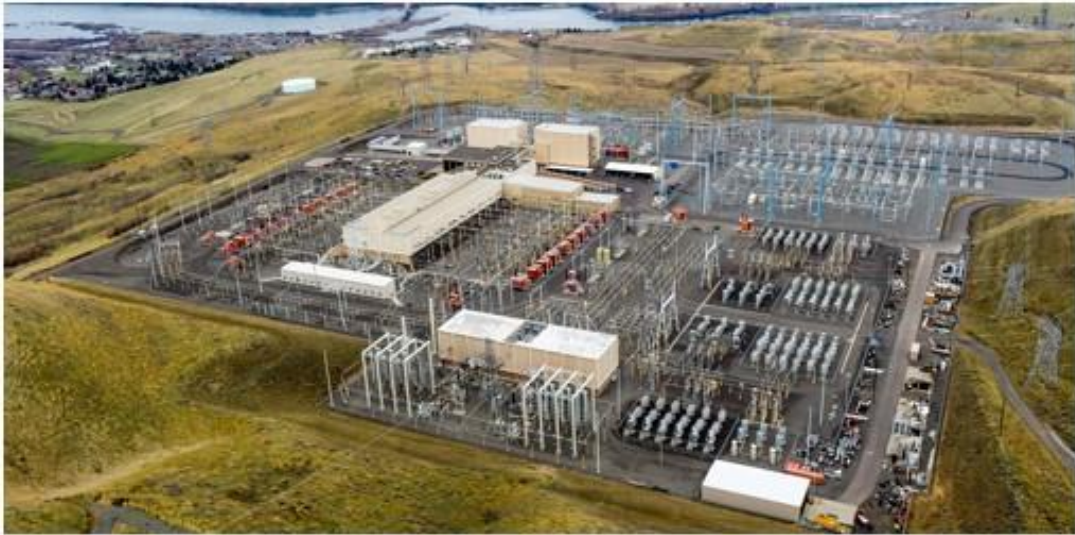
ΕΙΚΟΝΑ 57.ΣΤΑΘΜΟΣ ΜΕΤΑΤΡΟΠΗΣ ΕΝΕΡΓΕΙΑΣ.
