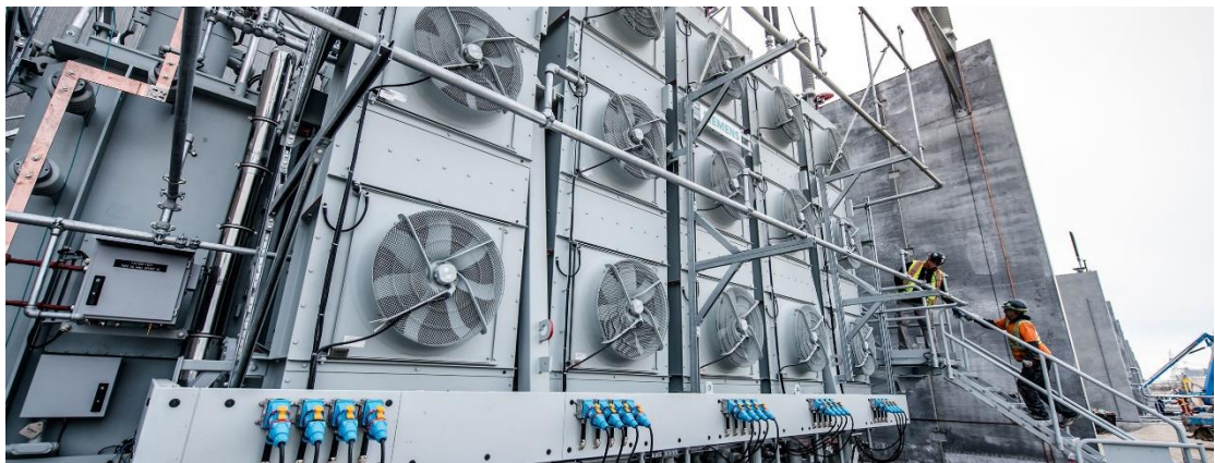
ΕΙΚΟΝΑ 59. ΣΥΣΤΗΜΑ ΨΥΞΗΣ ΕΦΑΡΜΟΓΗΣ ΣΕ ΜΕΤΑΣΧΗΜΑΤΙΣΤΕΣ ΚΑΙ ΔΙΑΚΟΠΤΕΣ ΙΣΧΥΟΣ
