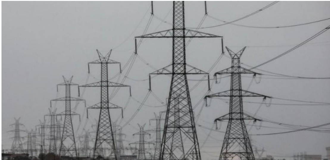
ΕΙΚΟΝΑ 1. ΠΥΛΩΝΕΣ ΕΝΑΕΡΙΑΣ ΜΕΤΑΦΟΡΑΣ ΗΛΕΚΤΡΙΚΗΣ ΕΝΕΡΓΕΙΑΣ(1)
