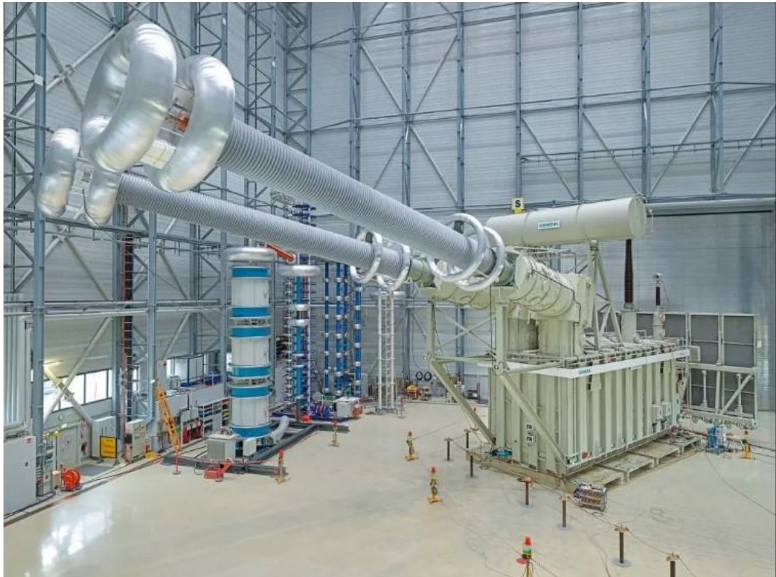
ΕΙΚΟΝΑ 46. ΜΟΝΟΦΑΣΙΚΟΣ ΜΕΤΑΣΧΗΜΑΤΙΣΤΗΣ 1,100 KV ΤΗΣ SIEMENS.
