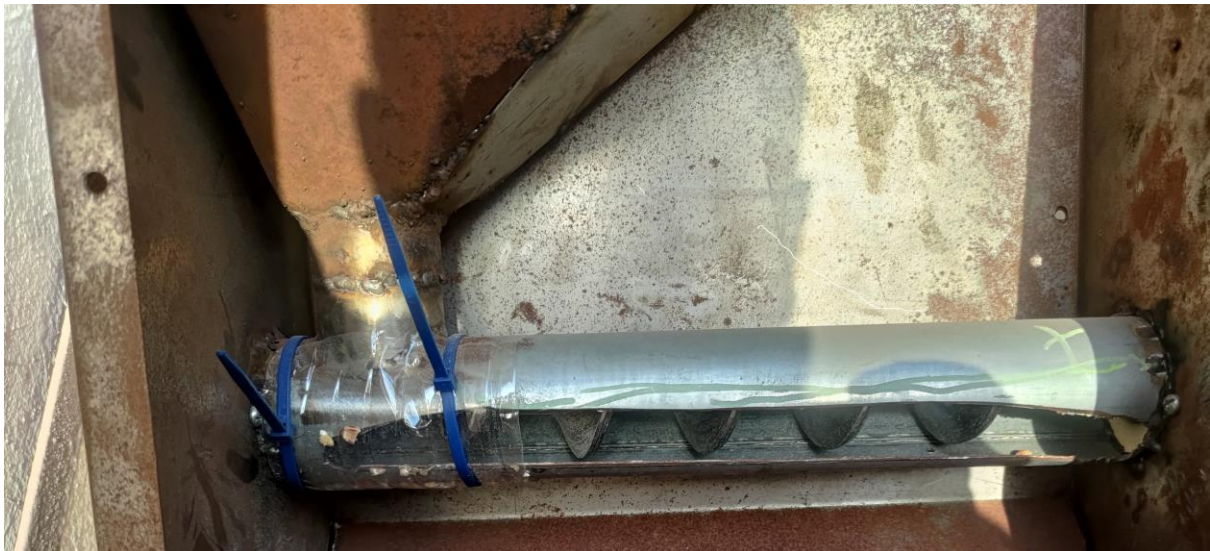
Εικόνα 3.3.1: Ένωση σιλού με σωλήνα
