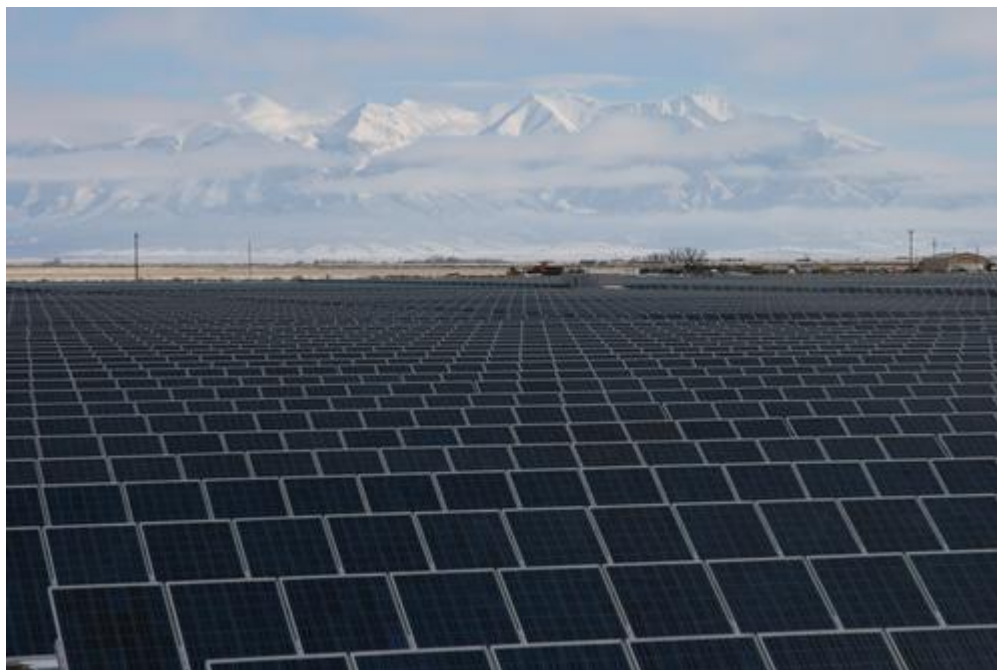
Εικόνα 2-2 Ηλιακές συστοιχίες. ( https://solareis.anl.gov/guide/solar/pv/index.cfm )
