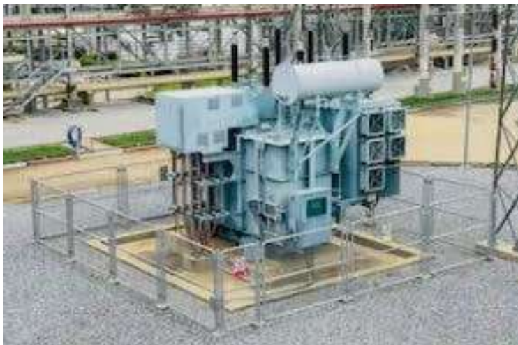
Εικόνα 3-1 Τριφασικός Μετασχηματιστής σε Υποσταθμό [ https://studyelectrical.com/2019/04/electrical-substation-equipment-types-components-functions.html ]
