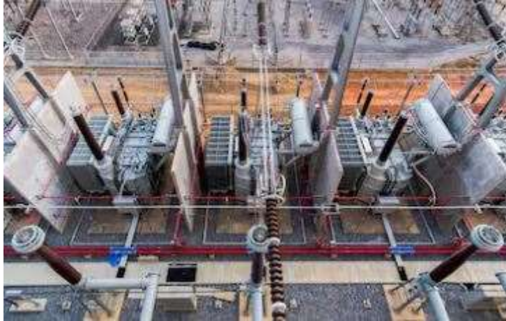
Εικόνα 3-2 Τρεις μονοφασικοί μετασχηματιστές σε συστοιχία [ https://studyelectrical.com/2019/04/electrical-substation-equipment-types-components-functions.html ]
