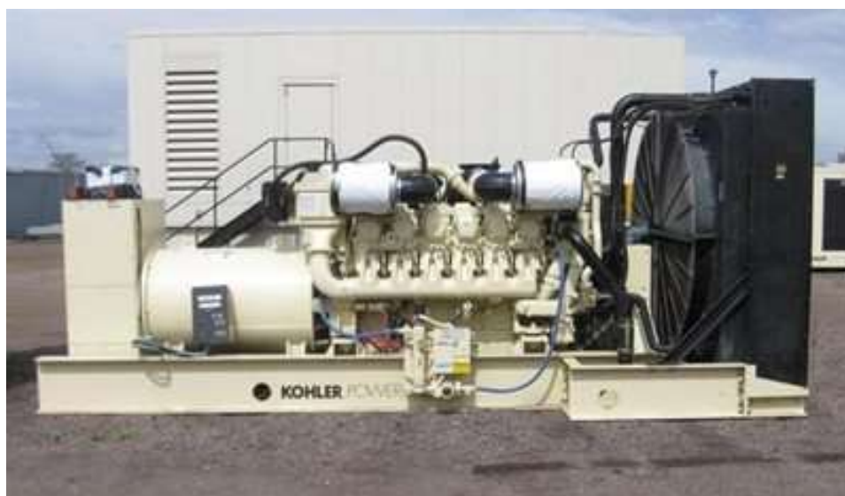
Εικόνα 5-1 Ηλεκτροπαραγωγό ζεύγος [ https://www.generatorsource.com/How_Generators_Work.aspx ]
