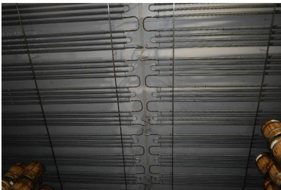
Εικόνα 11: Ψυκτικό στοιχείο θαλάμου συντήρησης φέτας
