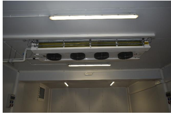
Εικόνα 10: Εσωτερικά στοιχεία μονάδων ψύξης-2
