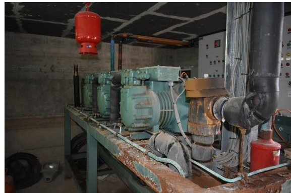
Εικόνα 4: Μηχανοστάσιο συμπιεστών ψυκτικών μονάδων
