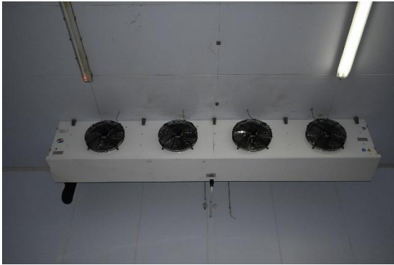
Εικόνα 9: Εσωτερικά στοιχεία μονάδων ψύξης-1
