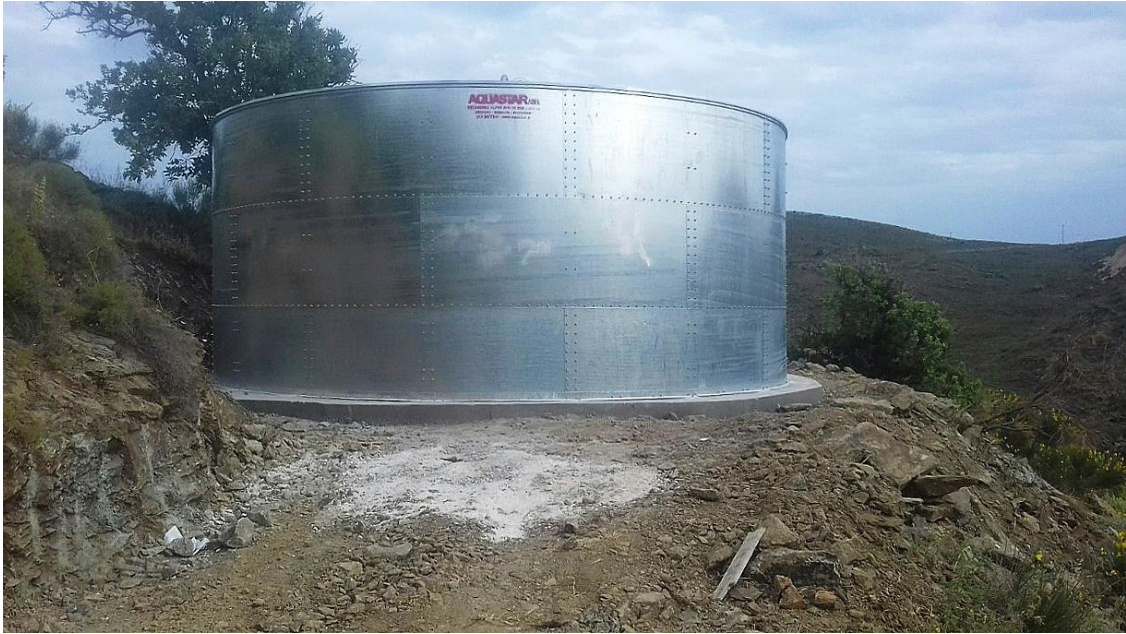
Εικόνα 32: Μεταλλική δεξαμενή αποθήκευσης νερού
