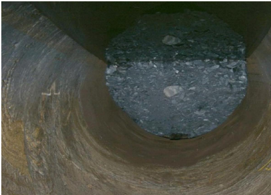
Σχήμα 4.3: Αποτυχία και καθίζηση πετρωμάτων και χόματος σε σήραγγα
