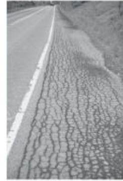
Edge fatigue crack
