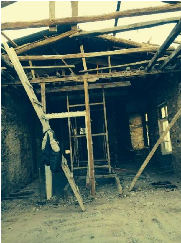
Εικόνα 3.1.3: Τμήμα στέγης του Α ορόφου με έντονες φθορές. Σελ.35
