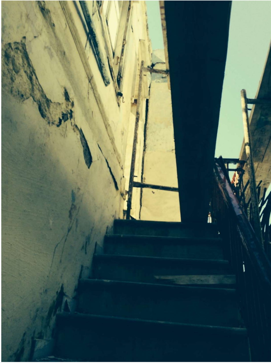
Εικόνα 3-2: Άποψη στις σκάλας ανόδου προς τον Α όροφο με εμφανή της ζημιές των επιχρισμάτων και των μαρμάρων.σελ.32
