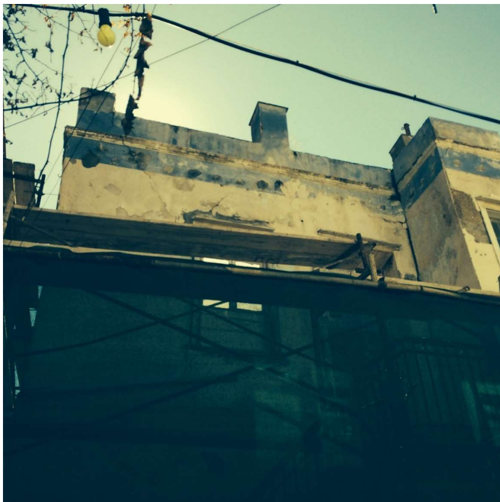
Εικόνα 3-1: Άποψη τμήματος της πρόσοψης με εμφανή τις ζημιές στα επιχρίσματα.
