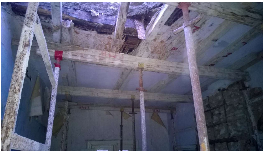
Εικόνα 3.1.3: Τμήμα οροφής στον χώρο Α2 του Α ορόφου με έντονες φθορές. Διακρίνεται η υποχώρηση του δαπέδου του βατού δώματος που αποτελεί και την οροφή του εν λόγω χώρου.
