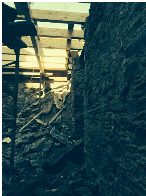
Εικόνα 2.2.2: Τμήμα δαπέδου βατού δώματος κατά την φάση αποκατάστασης του. Διακρίνονται τα προϊόντα κατάρρευσης
