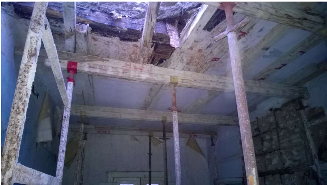
Εικόνα 3.1.3: Τμήμα οροφής στον χώρο Α2 του Α ορόφου με έντονες φθορές. Διακρίνεται η υποχώρηση του δαπέδου του βατού δόματος που αποτελεί και την οροφή του εν λόγω χώρου. Σελ.36
