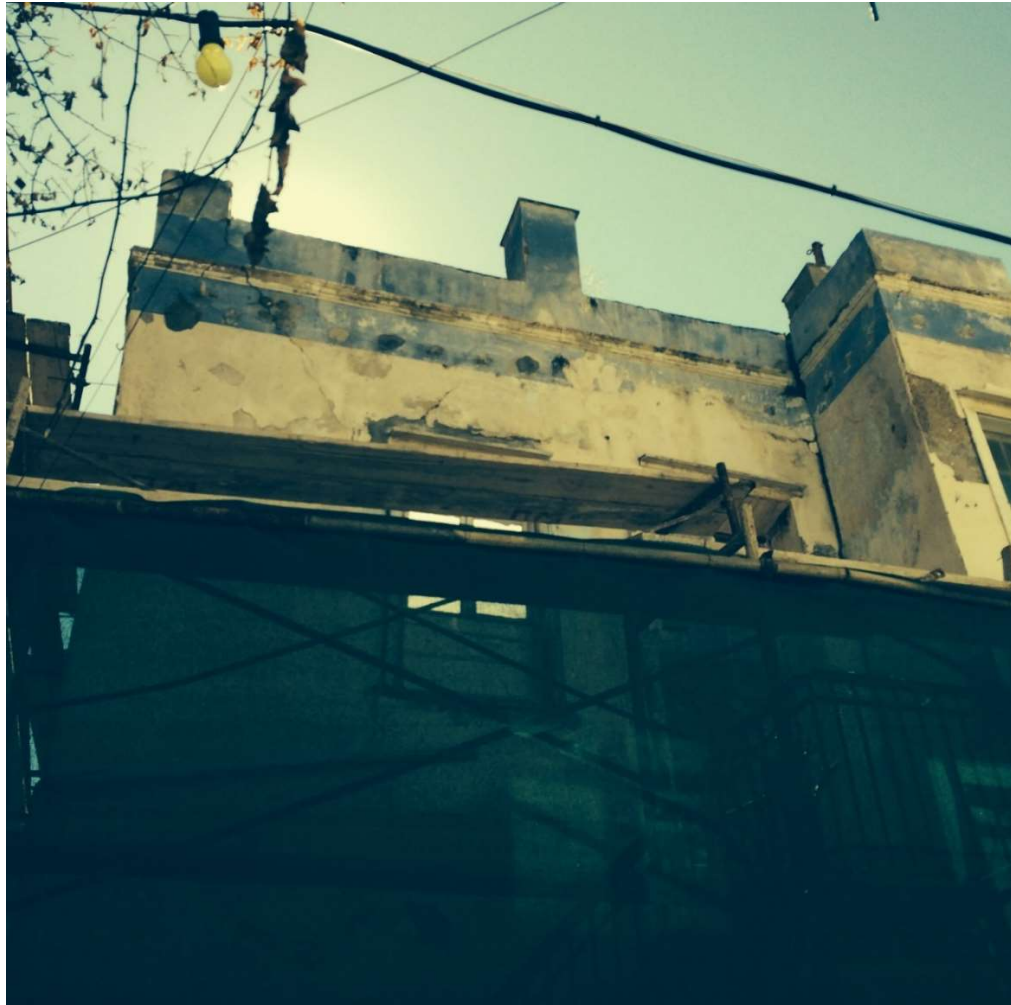
Εικόνα 3-1: Άποψη τμήματος της πρόσοψης με εμφανή τις ζημιές στα επιχρίσματα.σελ.31
