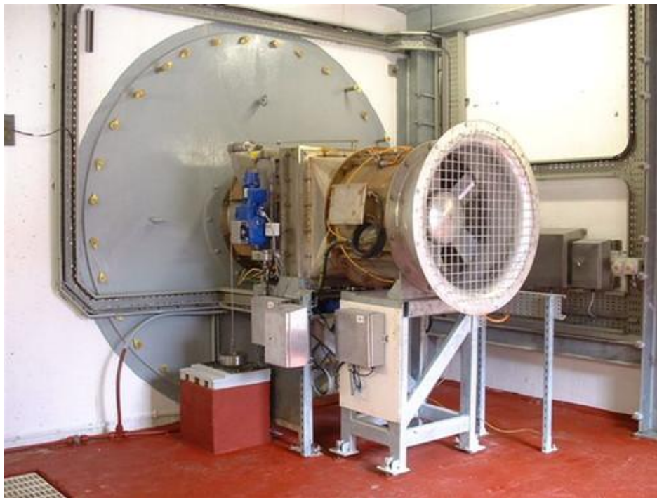
Εικόνα 4-19 Στρόβιλος Voith Hydro Wavegen RT1 στο LIMPET (18,5 kW).
