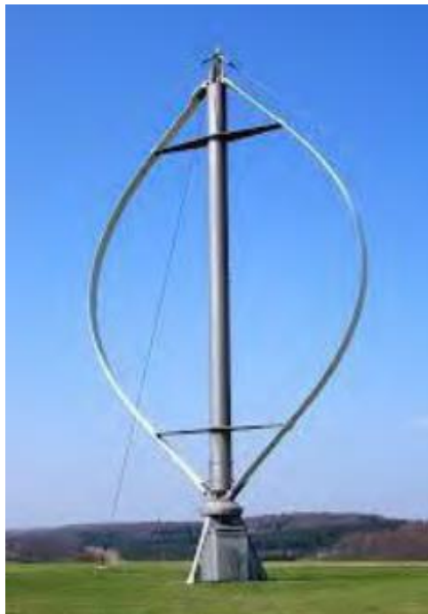
Εικόνα 2.2: Ανεμογεννήτρια κατακόρυφου άξονα.
