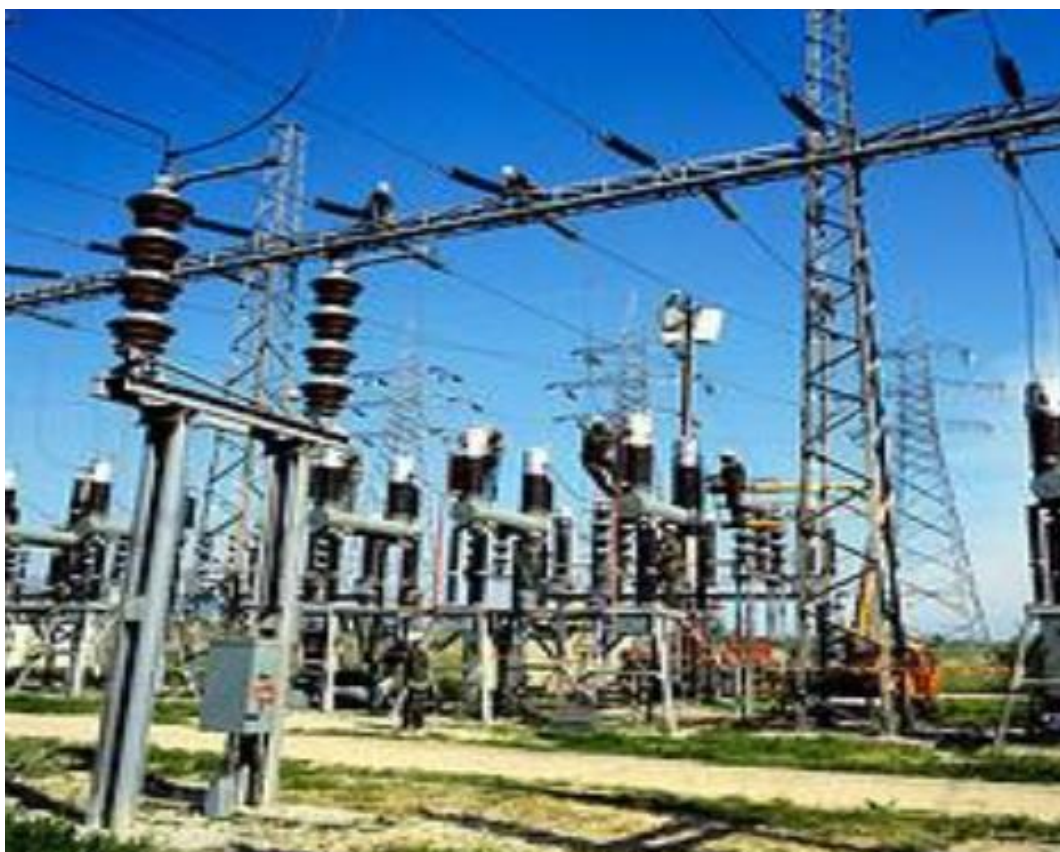
Εικόνα 5.17: Τυπικός υποσταθμός υψηλής τάσης 50.000 KVA, 150/21 Kv.
