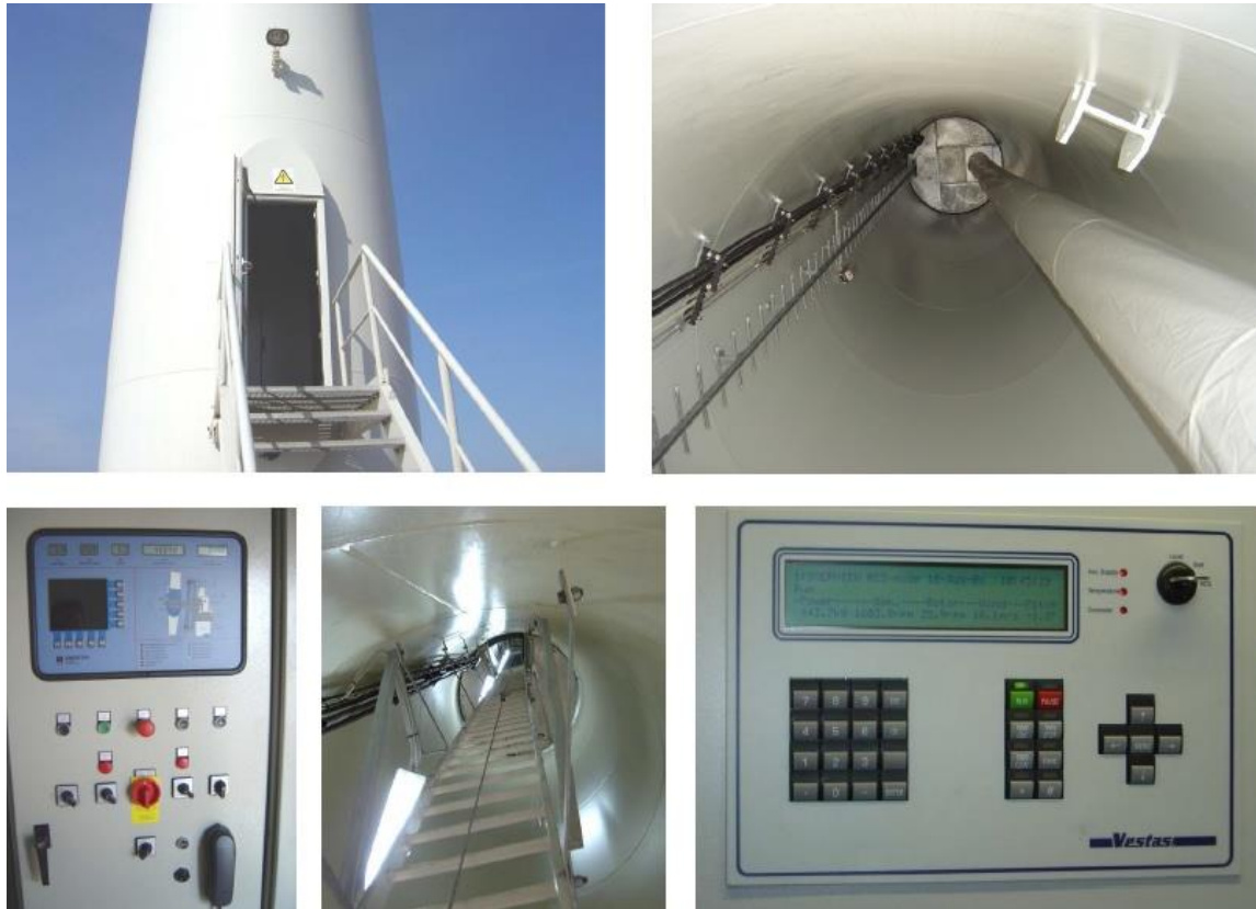
Εικόνα 5.6: Στο εσωτερικό μιας ανεμογεννήτριας.
