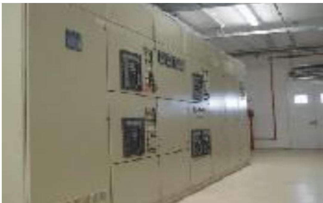
Εικόνα 5.16: Τυπικός υποσταθμός μέσης τάσης 0,4/15kV.
