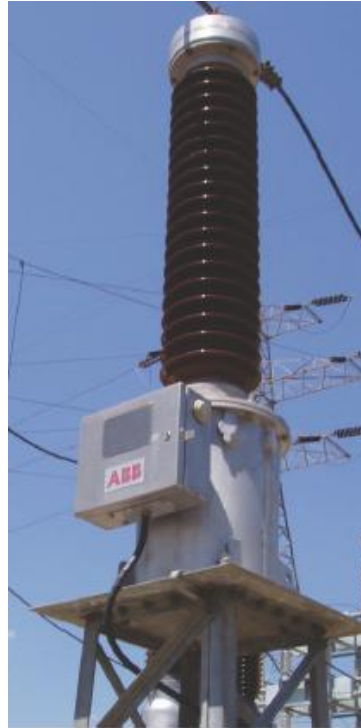
Εικόνα 7-6 Μετασχηματιστής τάσης 170kV
