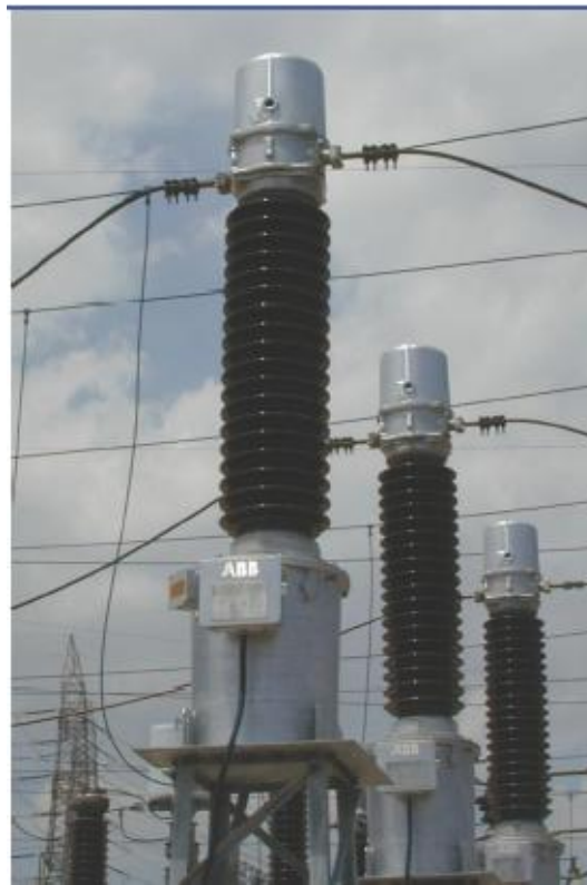
Εικόνα 7-5 Μετασχηματιστής έντασης 170kV
