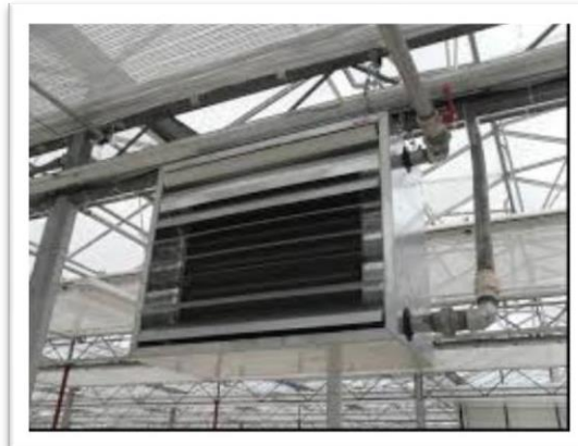
Εικόνα 24: Σύστημα θέρμανσης με αερόθερμο
